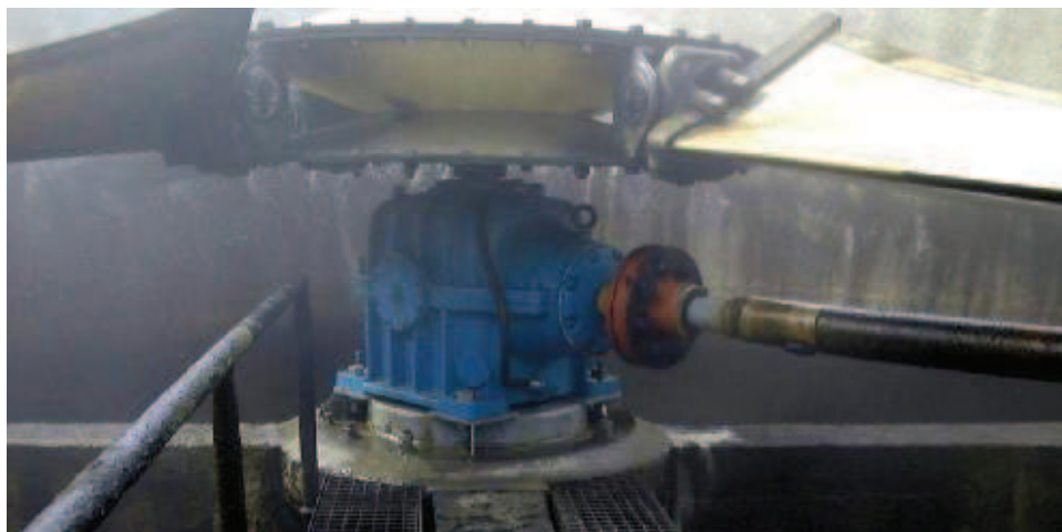
Prevodovky TSA 031 351-07, elektrárň Tisová, Česká republika
